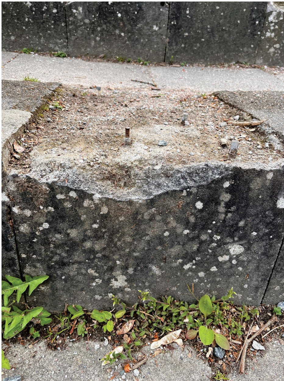
Treppe zur Gemeinschaftsschule mit erheblichen Schäden und Verletzungsgefahren!
