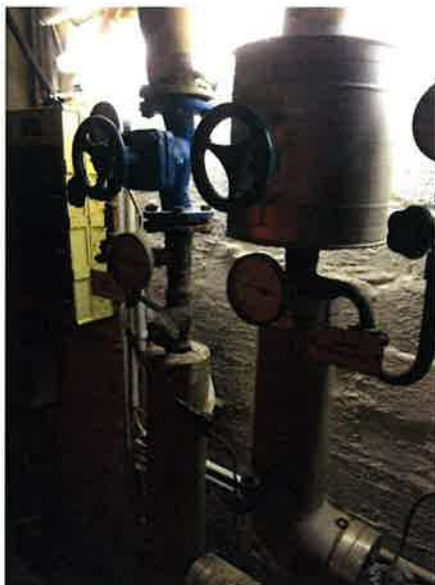
Abbildung 2: fehlende Dämmung an den Armaturen in der Zentrale
