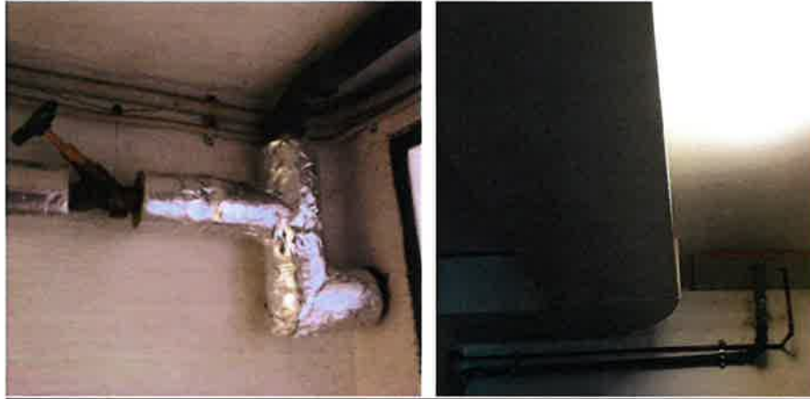
Abbildung 16: Ungenügende Isolierung der Trinkwasserleitungen
