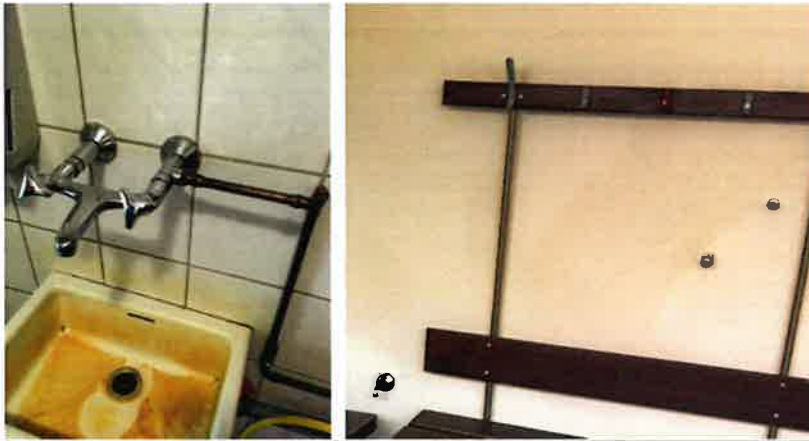
Abbildung 15: Totstrecke in der Bestandsinstallation
