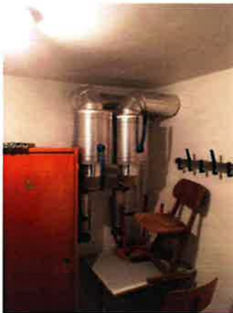
Abbildung 1 : Eintritt der Fernwärme in das Gebäude
