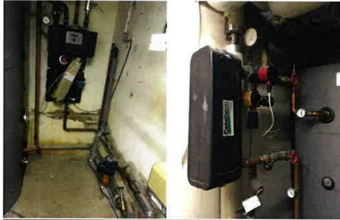
Abbildung 17: Varmeco Speicher Ladesystem (BJ 2010)
