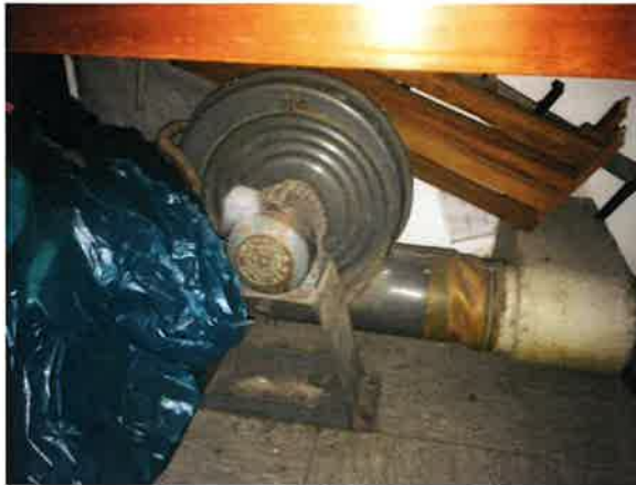
Abbildung 8: Abluftventilator im Bestand
