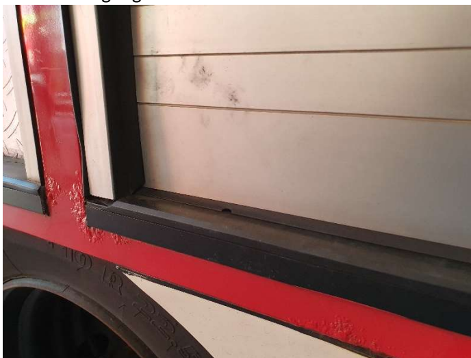
Bild 1: Korrosionsbildung am Laderaumaufbau. Dieses führt bereits zum Verspannen der Führungsschiene der Jalousie hinten links, was witterungsbedingt zum schwergängigen Öffnen dieser Jalousie führt.
