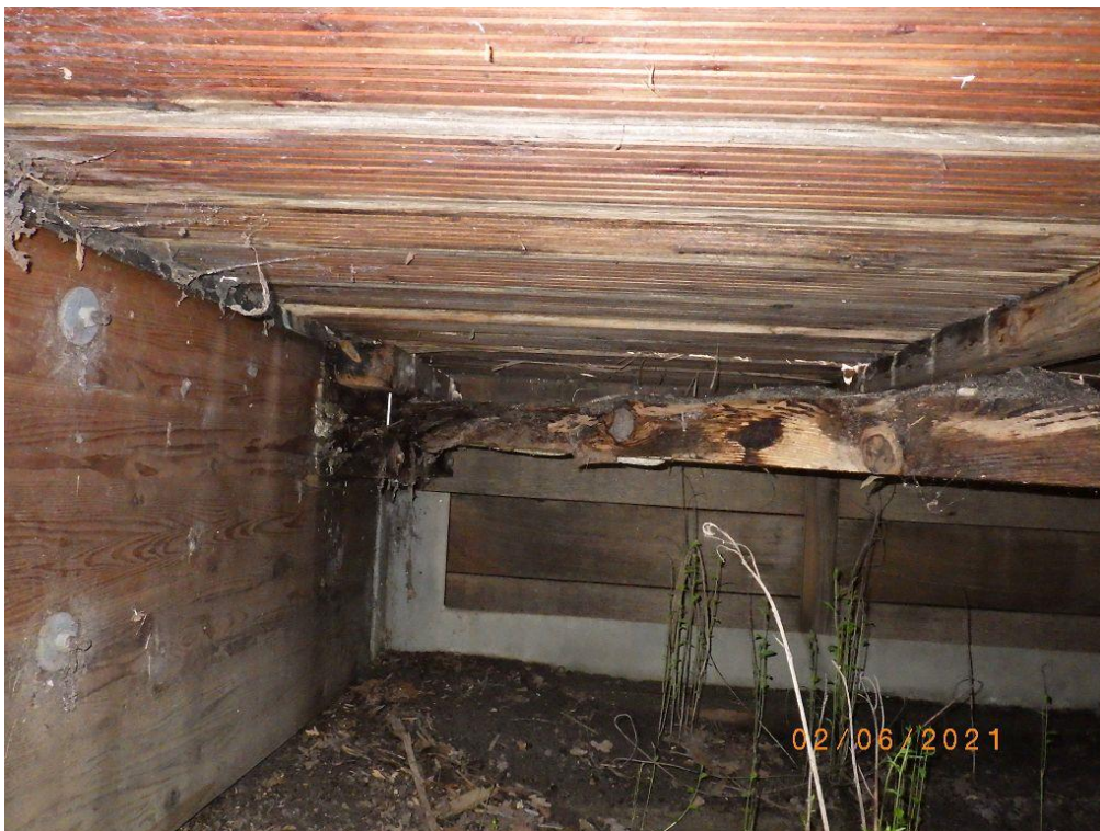
Foto Nr.: 4 – Bauwerksuntersicht – Längsträger/Auflagerbereich mit Versteifungsprofil + Diagonalverband
