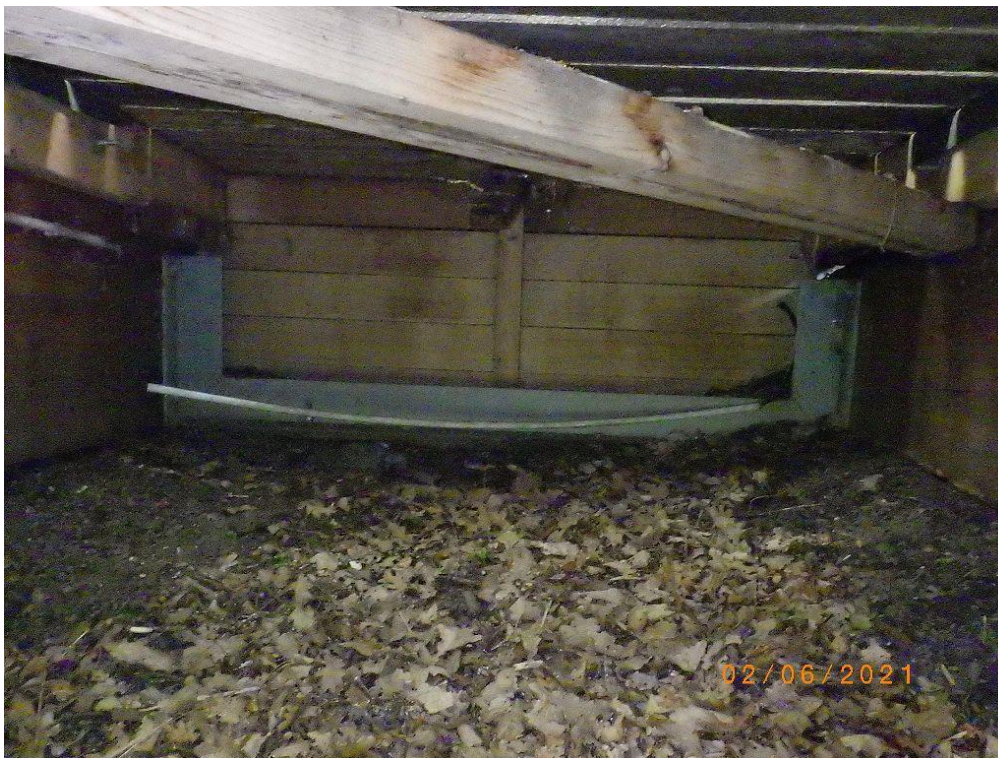
Foto Nr.: 4 – Bauwerksuntersicht – Längsträger/Auflagerbereich mit Versteifungsprofil + Diagonalstreben
