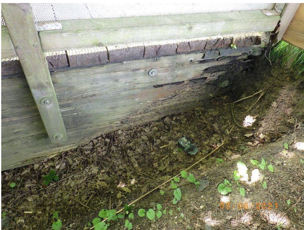
Foto Nr.: 5 – Schädigung im Auflagerbereich
