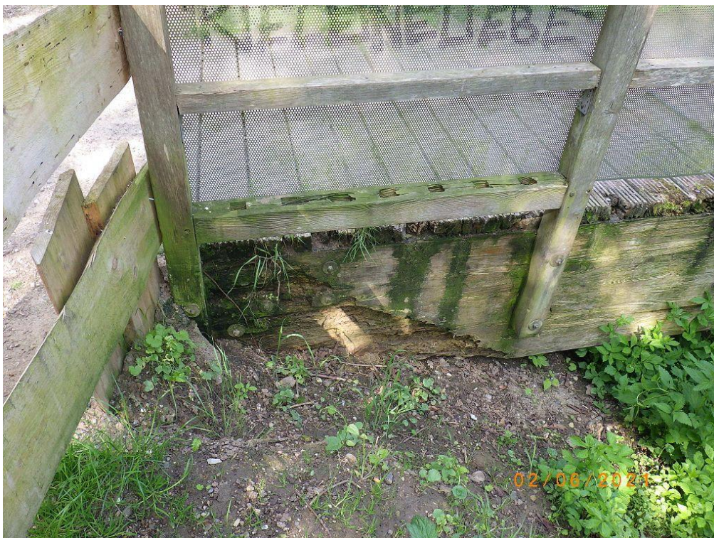
Foto Nr.: 5 – Schädigung im Auflagerbereich
