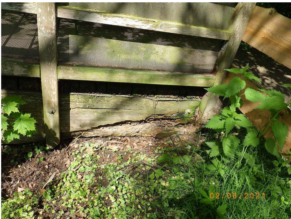
Foto Nr.: 5 – Schädigung im Auflagerbereich
